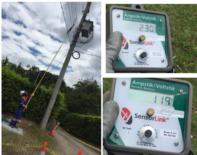
Fig. 3. Toma de Voltaje con Pinza sensor Link
