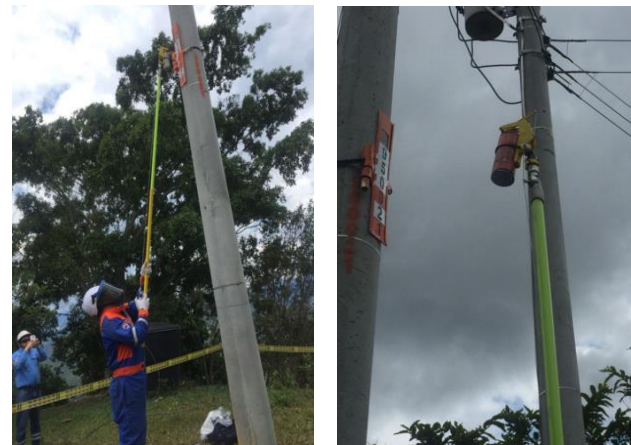
Fig. 5. Marcación de la infraestructura punto físico
